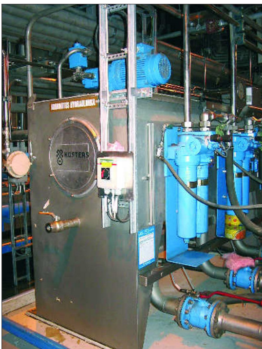
Hydraulikanlage des Kalenders
