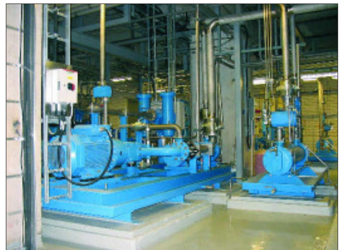
Blick in den Hydraulikkeller für den Kalander
